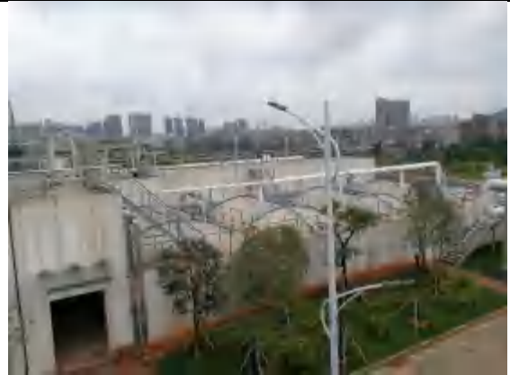
前置反硝化生物滤池
