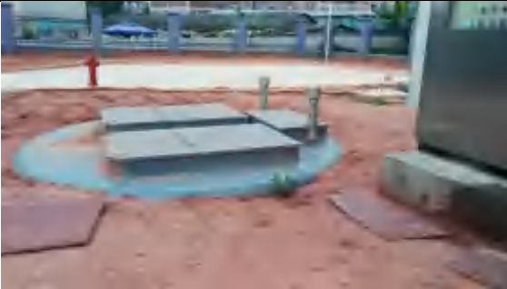
仲蒙沟提升泵站
