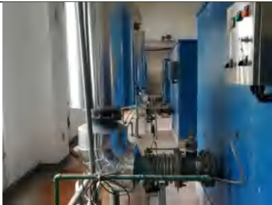
项目空压机房
