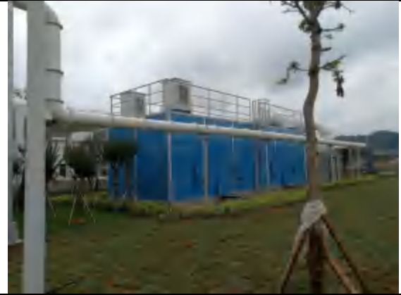
臭气收集管及生物除臭设施
