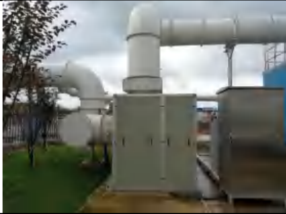
除臭设施风机
