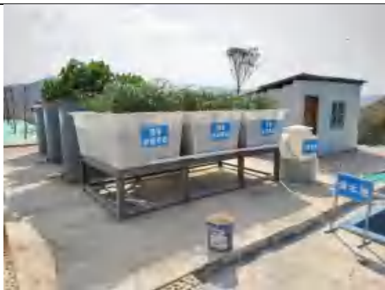
施工期生活污水 LM 处理系统
