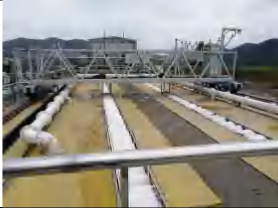
曝气沉砂池废气收集管
