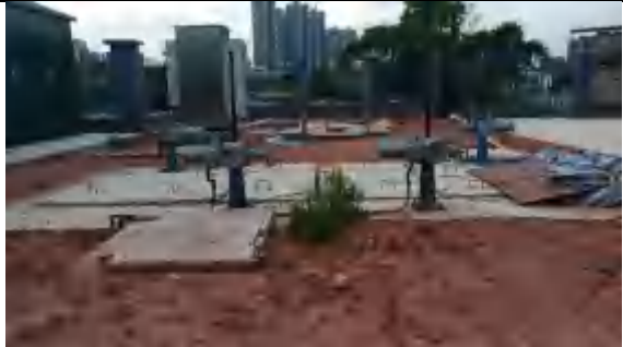
仲蒙沟提升泵站
