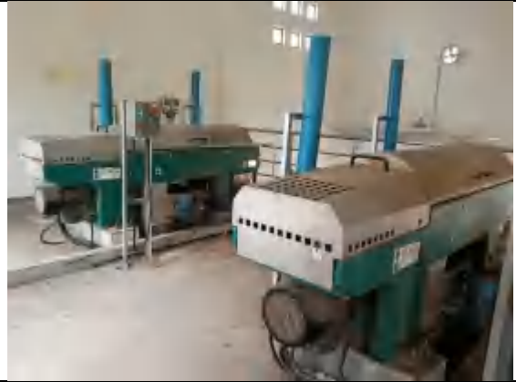
污泥脱水设施
