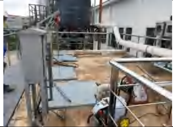
污泥储存池及废气收集系统
