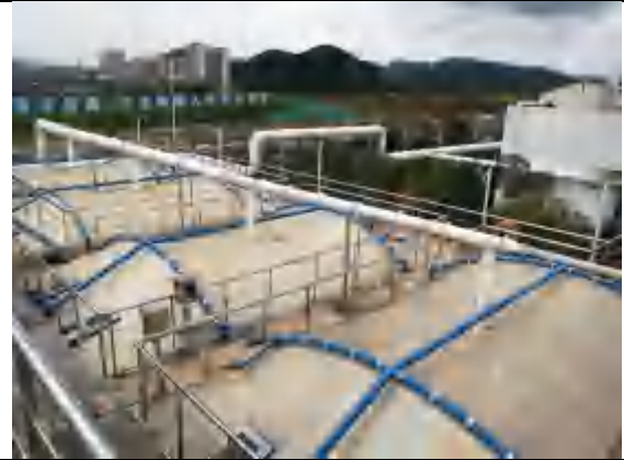
前置反硝化生物滤池废气收集管
