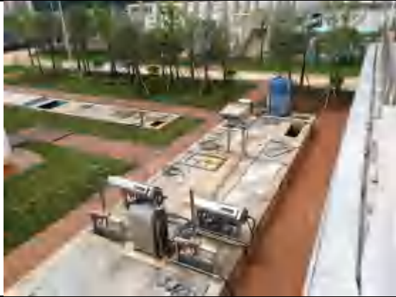
紫外线消毒设施
