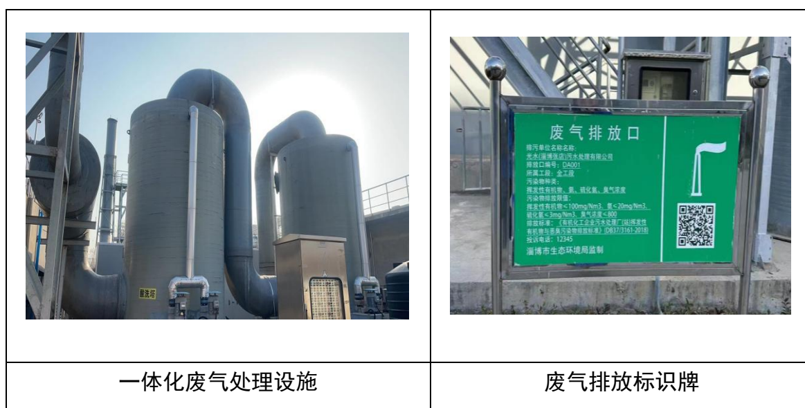
废气治理设施现场照片：
