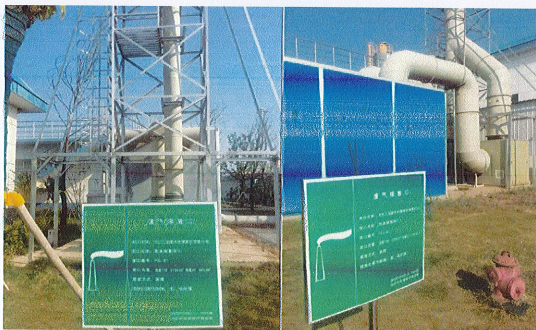
1 号生物滤池排口
